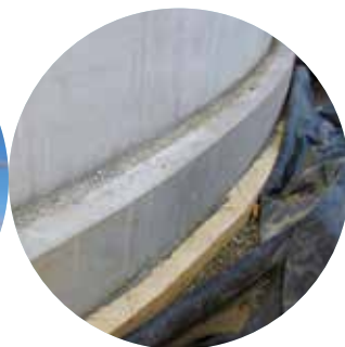
Temeljna plošča izolirana z izdelkom URSA XPS N-V-L
